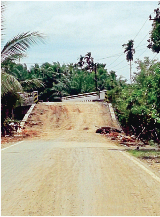
Gambar 10. Kondisi Jembatan di Kecamatan Woyla. Sumber: Hasil Observasi Lapangan, 2017.
